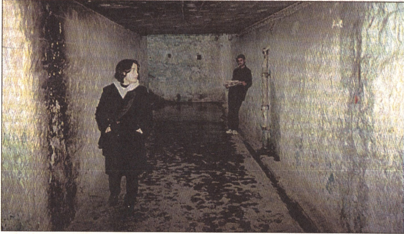
Tren yolu altgeçitleri pisliliği ve bakımsızlığı nedeniyle de vatandaşların şikâyetlerine neden oluyor...
